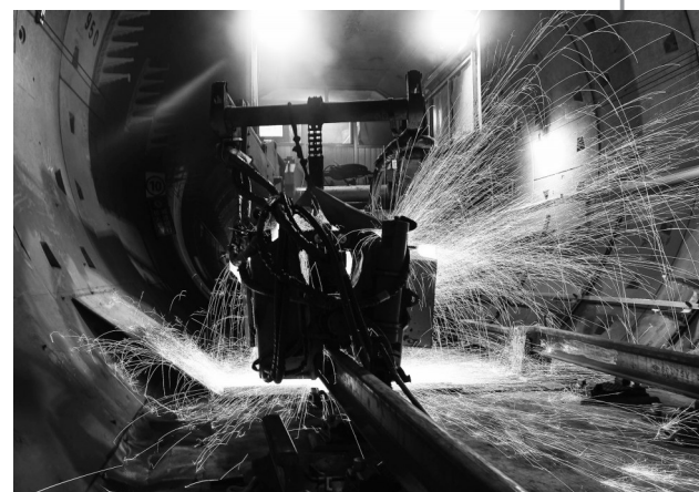
4月11日，由中铁上海工程局等单位承建的广州地铁11号线在南石路隧道开始全线长轨焊接。地铁11号线是广州首条环线地铁，串联起珠江两岸主城区，并连接广州火车站、广州东站等大型交通枢纽。（新华）
